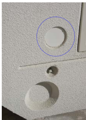
Figura 1.3: Detalle de entrada auxiliar de acometida de BT
