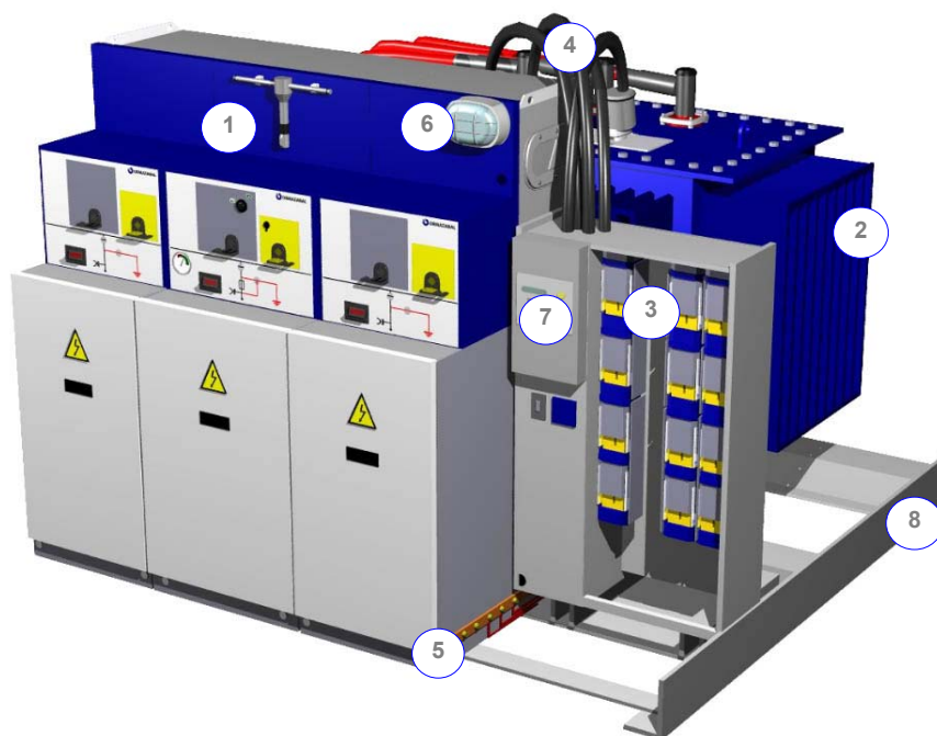
Figura 1.5: Detalle de equipo eléctrico MB
